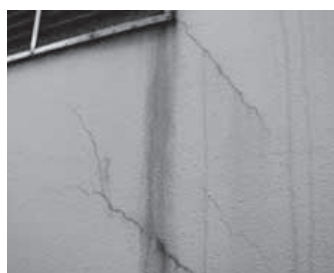
写真-1 ひび割れ
