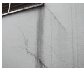
写真-1 ひび割れ
